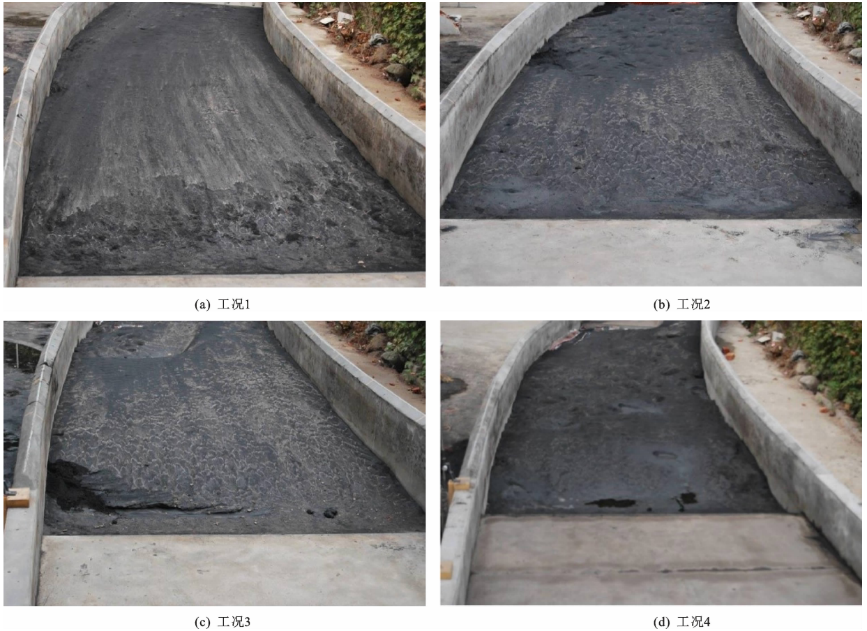
图 8 隧址断面冲刷形态
