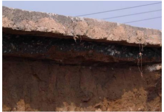
图 4 边坡整体浅层滑塌
