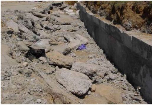
图 2 路基陷穴引发塌陷
