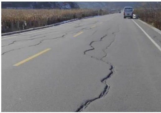
图 3 软基引起路面沉降
