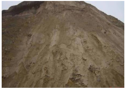
图 5 边坡冲刷破坏
