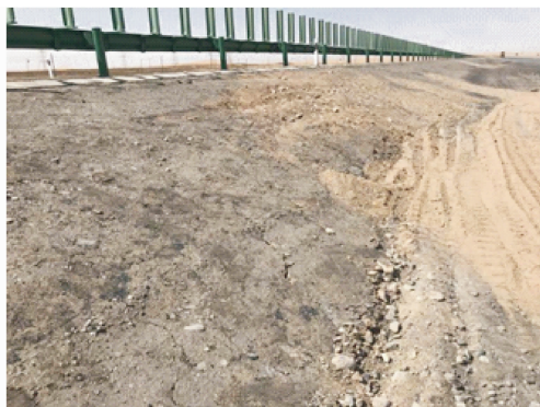
(a) 路基沉降裂缝
