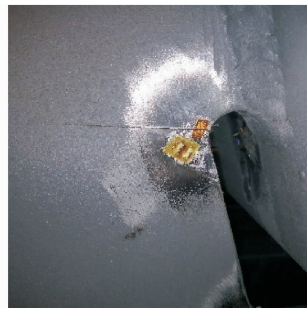
图 12 弧形切口处疲劳裂纹
